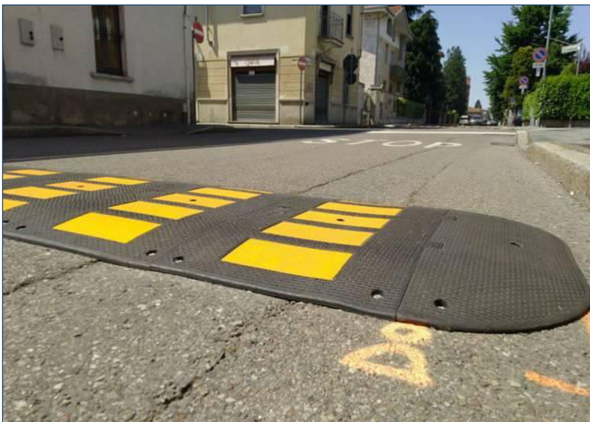
Figura 2-18 Dosso prefabbricato con le caratteristiche striature gialle e nere
